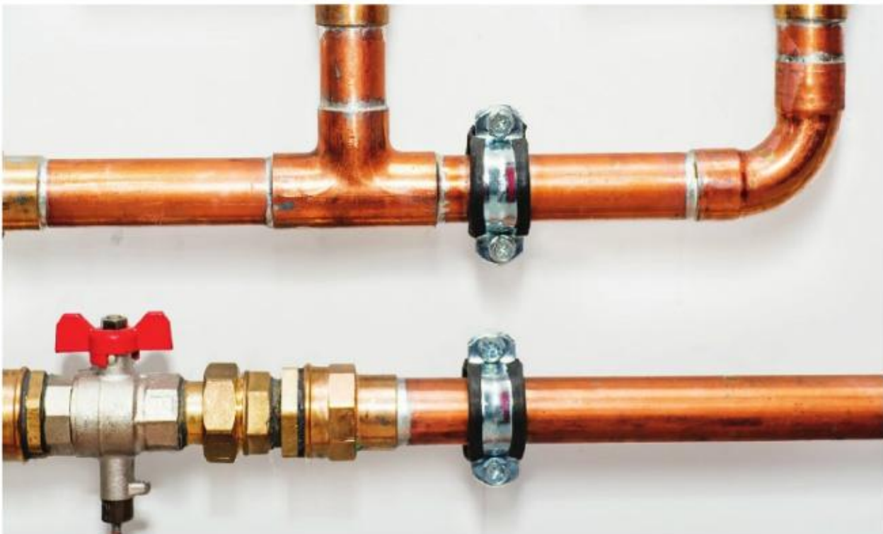
3.13 Rury i przewody wykonane z miedzi są doskonałymi przewodnikami prądu elektrycznego i ciepła
