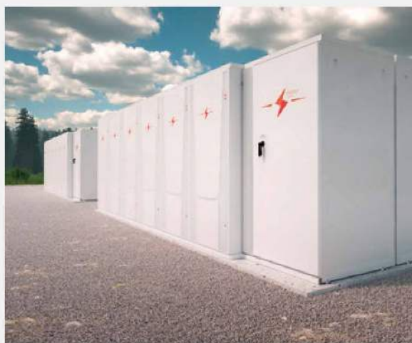
▲ Ogromne zestawy baterii litowo-jonowych to jeden z pomysłów na zapewnienie stabilności dostaw energii również w nagłych wypadkach np. po klęskach żywiołowych
