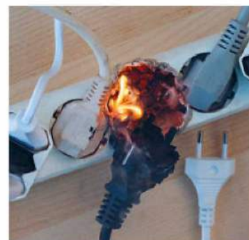
▲ Zbyt obciążony rozgałęźnik
