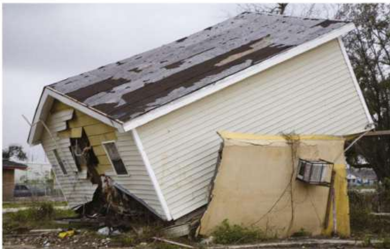
Budynek zniszczony w wyniku huraganu Katrina, Nowy Orlean w USA
