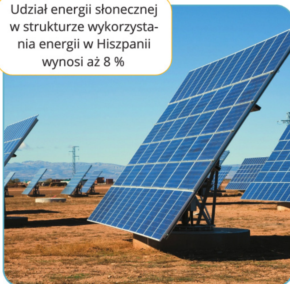
Panele elektrowni słonecznej w Andaluzji w Hiszpanii
