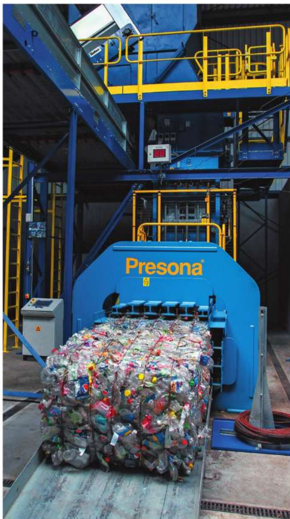
▲ Automatyczna sortownia odpadów komunalnych w Krakowie
