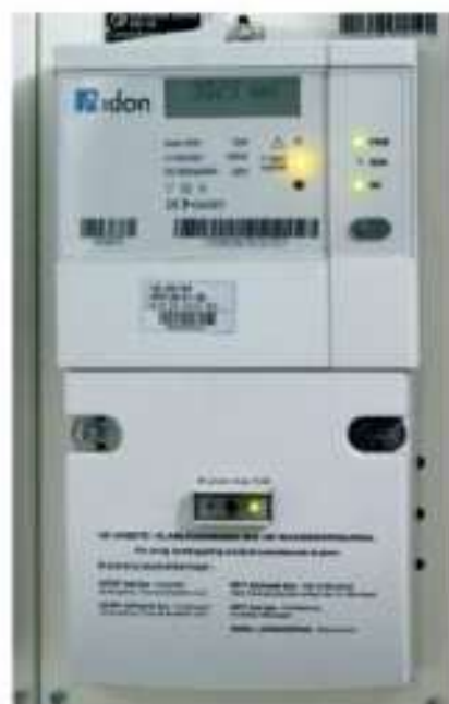
Rys. 7. Licznik kilowatogodzin energii elektrycznej.
