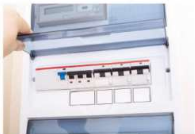
Rys. 20. Domowa rozdzielnica elektryczna.
