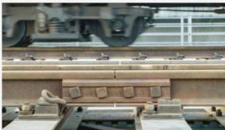
Rys. 4.16. W zimie przy bardzo niskich temperaturach można zauważyć, że między kolejnymi szynami są szerokie odstęp. Natomiast w lecie przy wysokich temperaturach odstęp są niemal niewidoczne.
