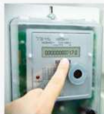
Rys. 1.21. Licznik energii elektrycznej.
