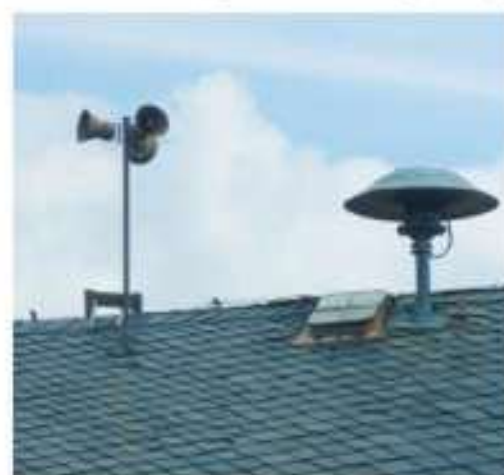
Syrena alarmowa na dachu budynku
