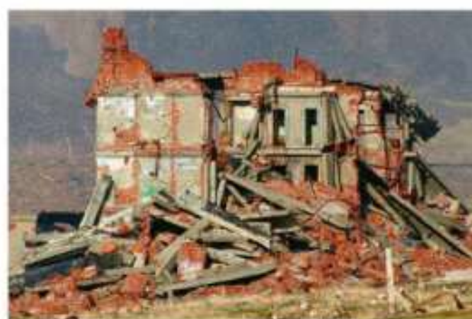
Zawalony budynek mieszkalny
