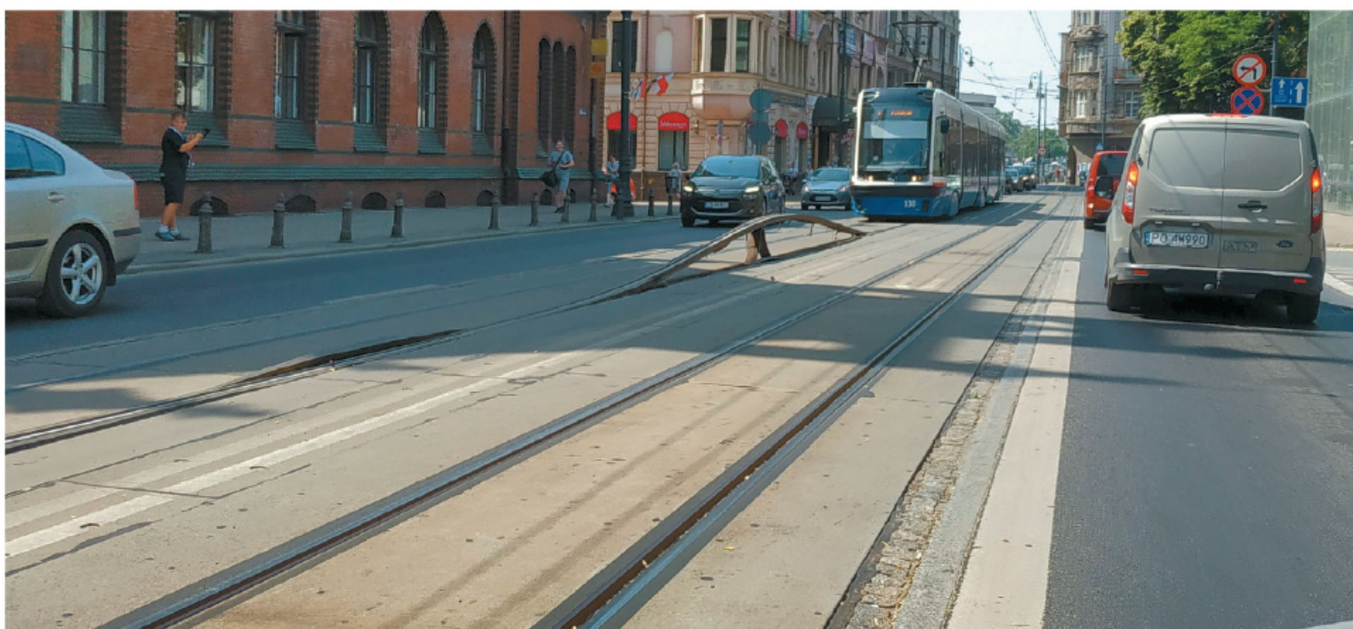
Ryc. 18.4. Podczas upałów panujących w Bydgoszczy naprężenia powstałe w torach tramwajowych spowodowały wysadzenie ich z podłoża
